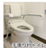
手すり付トイレ
